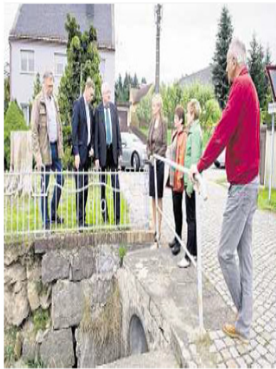
Ortsbegehung mit Umwelt-Staatssekretär Herbert Wolff (3.v.l.): Diese Mauer in Niedersteina kann nicht saniert werden – auch weil die gemeindlichen Eigenmittel knapp sind. Doch ohne die fließen keine Fördermittel. Foto: Kristin Richter
