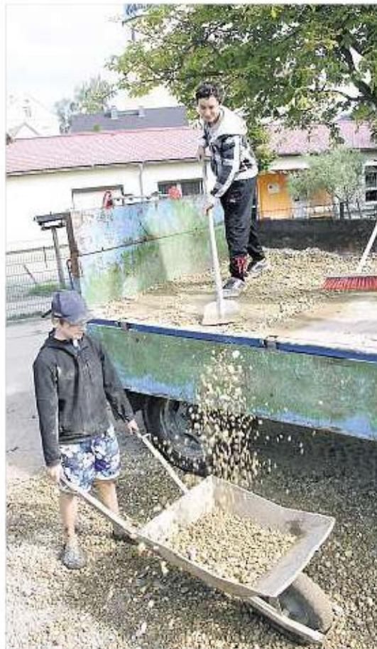
Die Außenanlagen der Crostwitzer Kita (Im Hintergrund) wurden in diesem Jahr schon drei Mal durch Schlammfluten überschwemmt. Bei den Aufräumarbeiten nach dem August-Hochwasser packten auch Schüler der Mittelschule Ralbitz mit an. Hier bringen sie Kies auf die verschlammten Flächen. Archivfoto: Schumann
