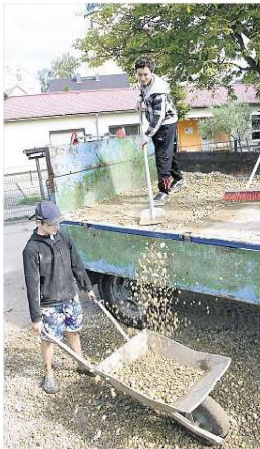
Die Außenanlagen der Crostwitzer Kita (im Hintergrund) wurden in diesem Jahr schon drei Mal durch Schlammfluten überschwemmt. Bei den Aufräumarbeiten nach dem August-Hochwasser packten auch Schüler der Mittelschule Ralbitz mit an. Hier bringen sie Kies auf die verschlammten Flächen. Archivfoto: Schumann
